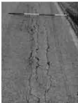
Figure II-6 Affaissement de rive
