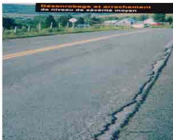
Figure II-11 désenrobage et arrachement de bitume
