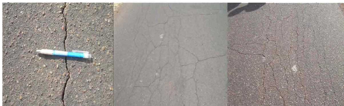
Figure IV.6 : Évolution de la dégradation d'une simple fissure vers un faïençage en passant par un maillage serré.
