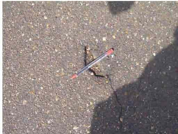
Figure IV.9 : Mottes sur le revêtement en sand asphalt
