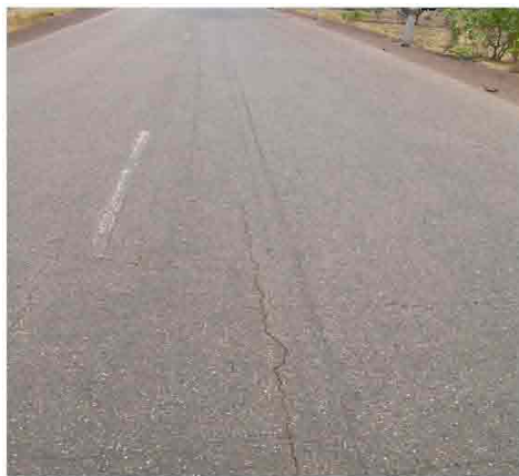
Figure IV.7: Fissures longitudinales sur ornières créées sur les traces des roues
