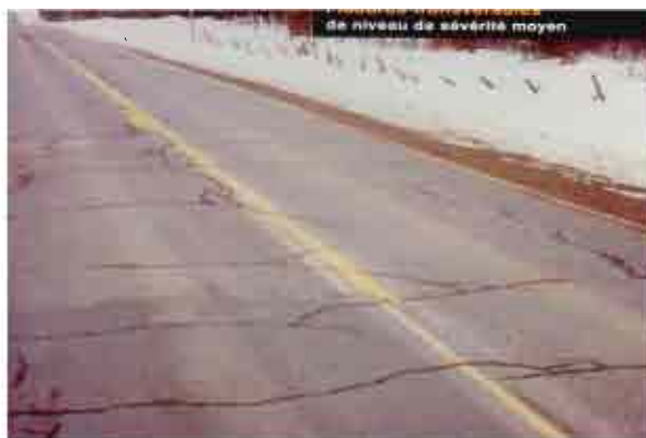
Figure II-1 Fissurations transversale sur une chaussée à revêtement bitumineux
