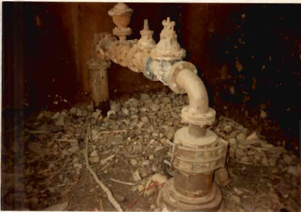
4. - Forage I. : artésien, observer la corrosion des canalisations.
