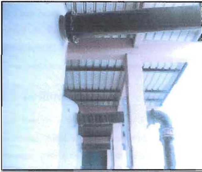
Photo 1 : Arrivée et montée de l'eau brute jusqu'au ruisseleurs.
