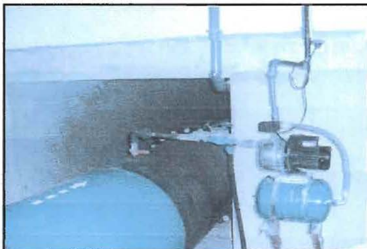
Photo 3: Injection du chlore dans la conduite d'eau filtrée
