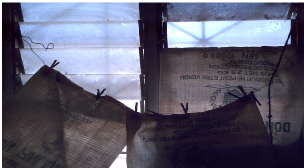
Figure 4 : Etat des fenêtres
