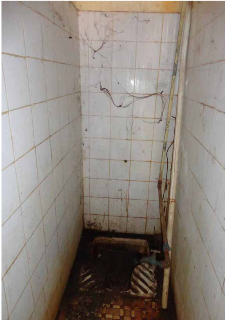
Figure 28 : Toiles d'araignée et accumulation des matières fécales dans le w.c
