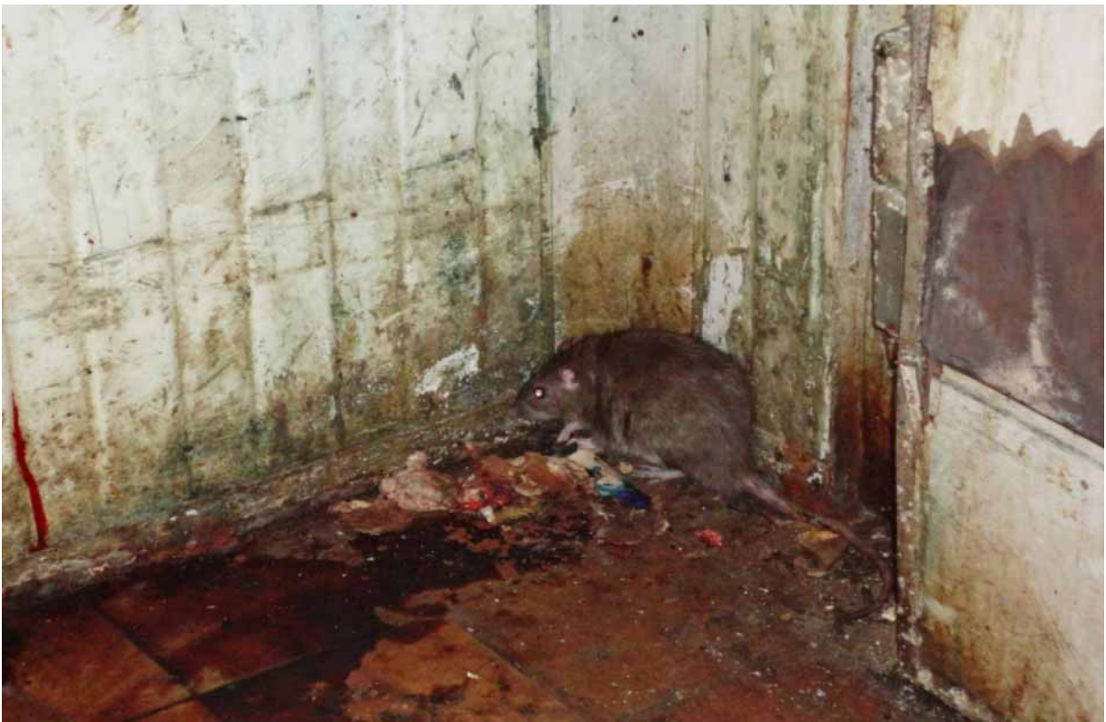
Figure 14: Recoins de chambre froide avec accumulation de la crasse et présence de rats
