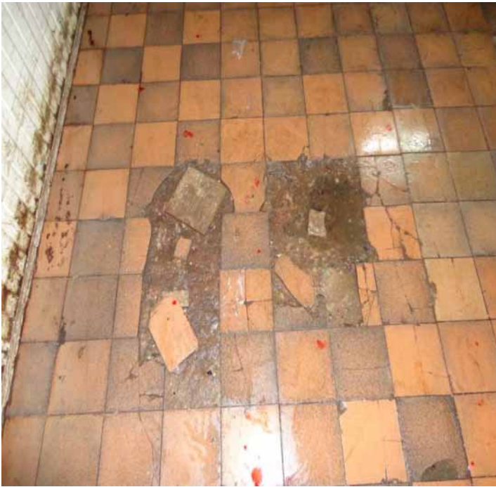
Figure10 : Cassures des carreaux sur le sol
