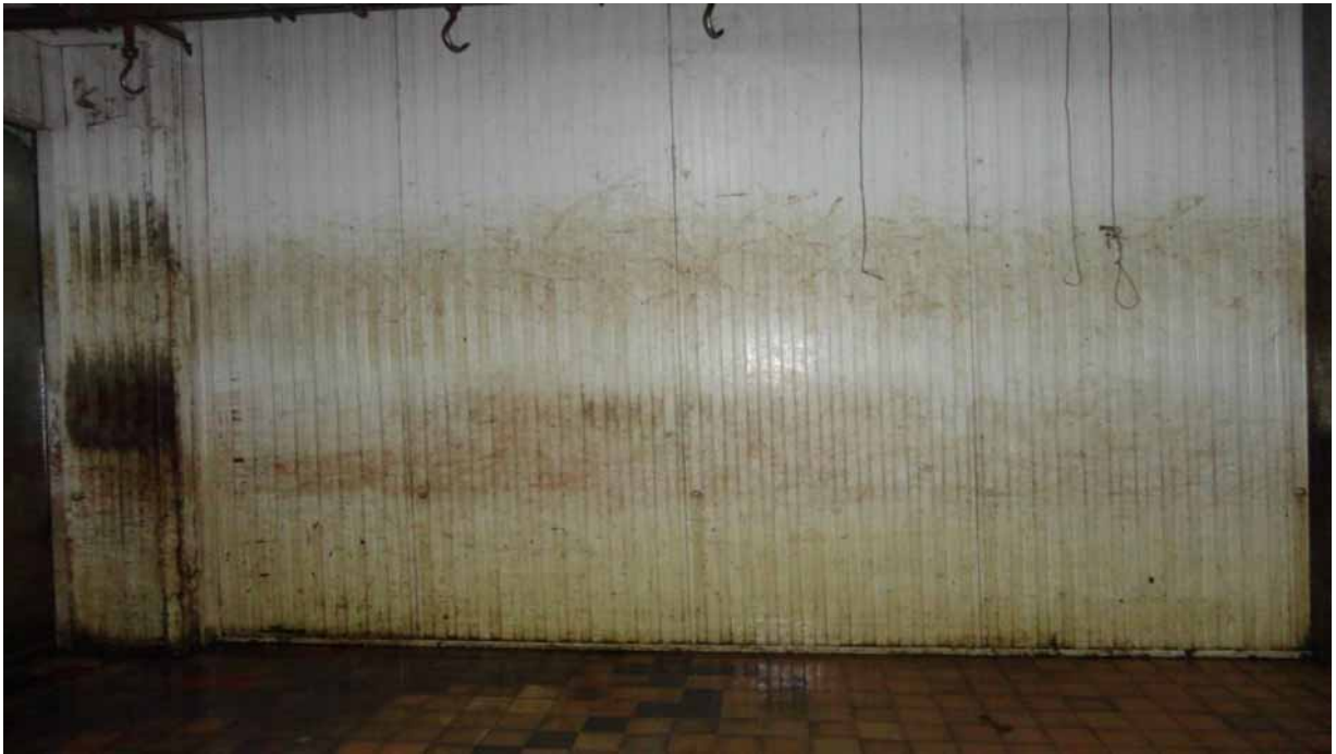
Figure 13 : Parois non nettoyées
