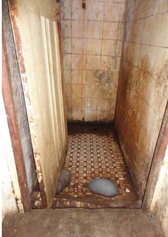
Figure 27 : Présence de la crasse sur le revêtement des murs et sol
