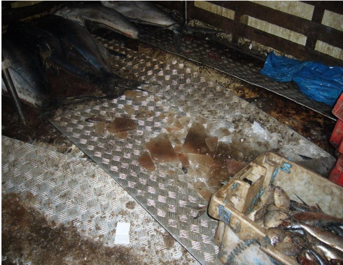
Photo3 : Chambre froide positive en panne
