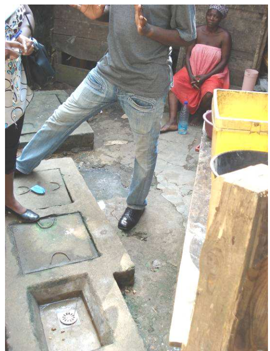
Ouvrage d'évacuation des eaux usées à Edéa, Cameroun.
