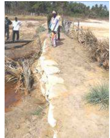
Les réparations en sacs de riz effectuées sur la digue anti-sel de Kabadio
