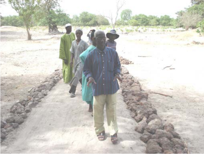
Diguette en cours de réalisation par les villageois pour compléter l'action de la digue de Marakissa.
