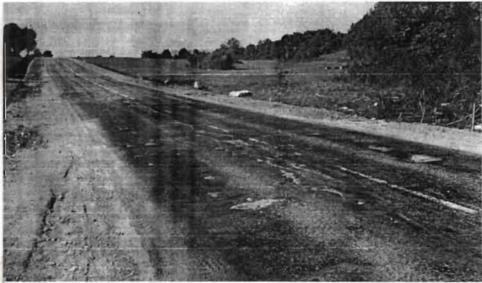
Avant : état d'une zone dégradée
