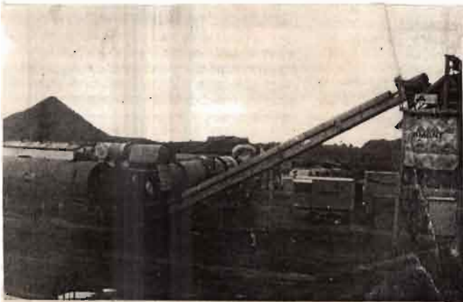
Photo 3 Le poste à tambour sècheuse enrobeur
