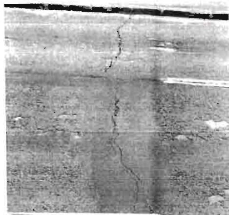
Exemple de fissuration des dalles de béton non goudonnées de la chaussée du CD 909 à Viarmes traitées par le procédé Flexiplast
