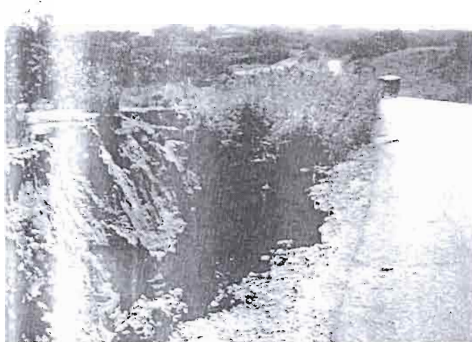
Photo 46 Destruction par affouillement de l'ac- cotement. L'érosion atteint le bord de la chaussée
