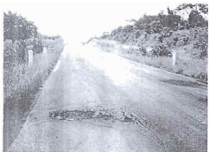
Photos 23-24 Défauts structurels de la chaussée après réparations.
