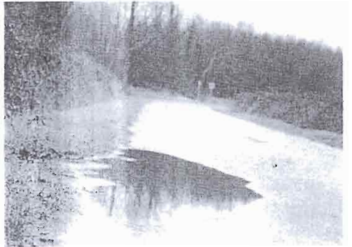
Photo 4 Affaissement localisé matérialisé par l'eau qui stagne.
