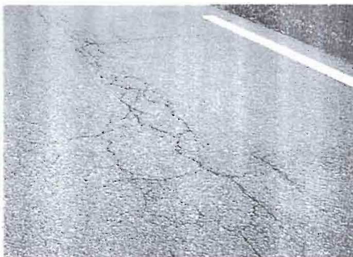
Photo 8 Fissure longitudinale ramifiée
