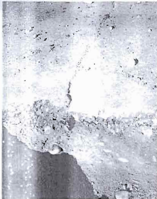
Photo 38 Scandage. La coupe de chaussée montre sans équivoque que la fissure est limitée à l'enrobé.
