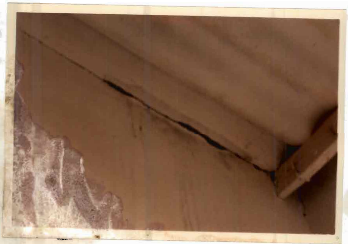
Figure 5.1 : Mauvaise étanchéité aux positions de rive
