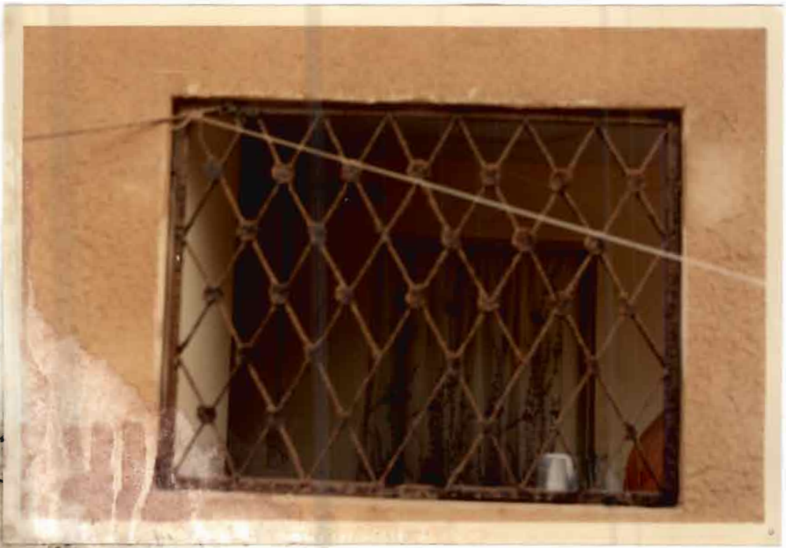
Figure 5.7 : Corrosion des grilles métalliques due à la proximité de la mer (cité Diamalaye).
