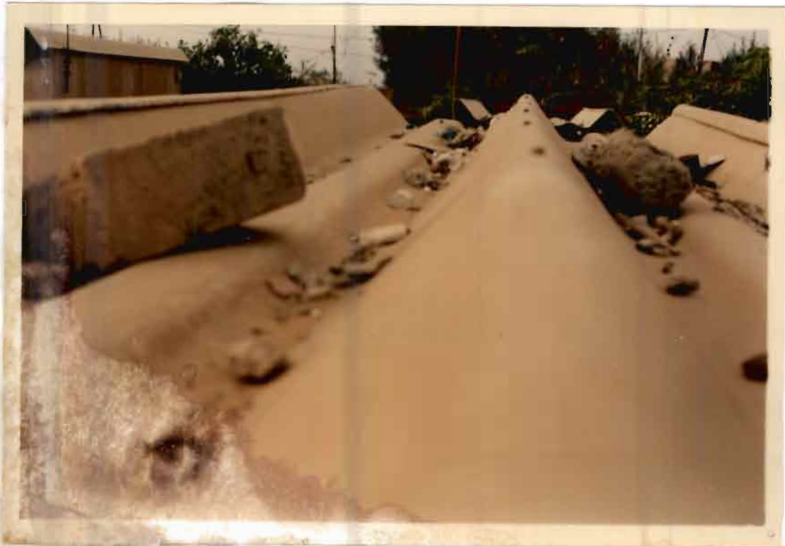
Figure 5.4 : Utilisation abusive des toitures.
