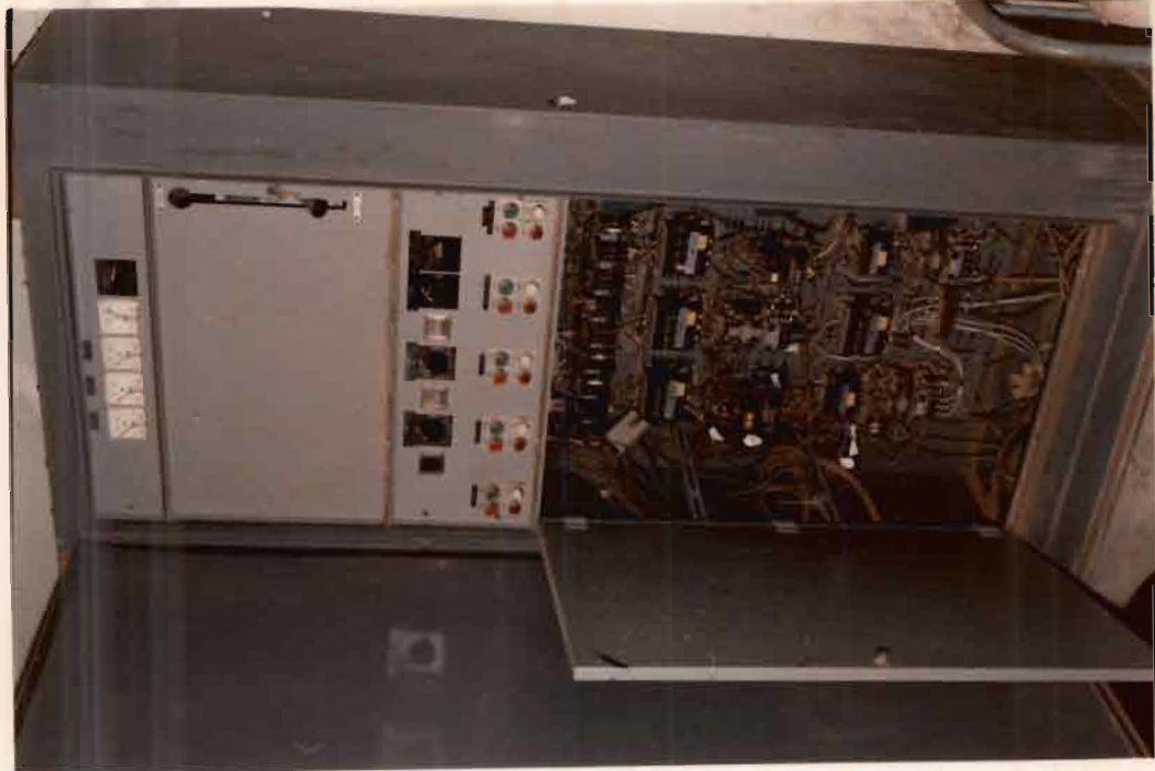
↑ Photo n°6 : PRÉSENTATION DE L'ARMOIRE ÉLECTRIQUE MONTRANT LES CONNEXIONS
