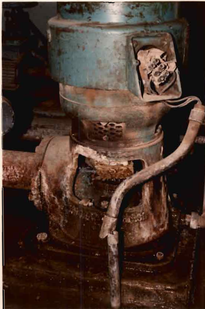
↑ Photo n°4 : VUE AGGRANDIE MONTRANT L'ÉTAT DE L'UNIQUE ÉLECTROPOMPE EN SERVICE
