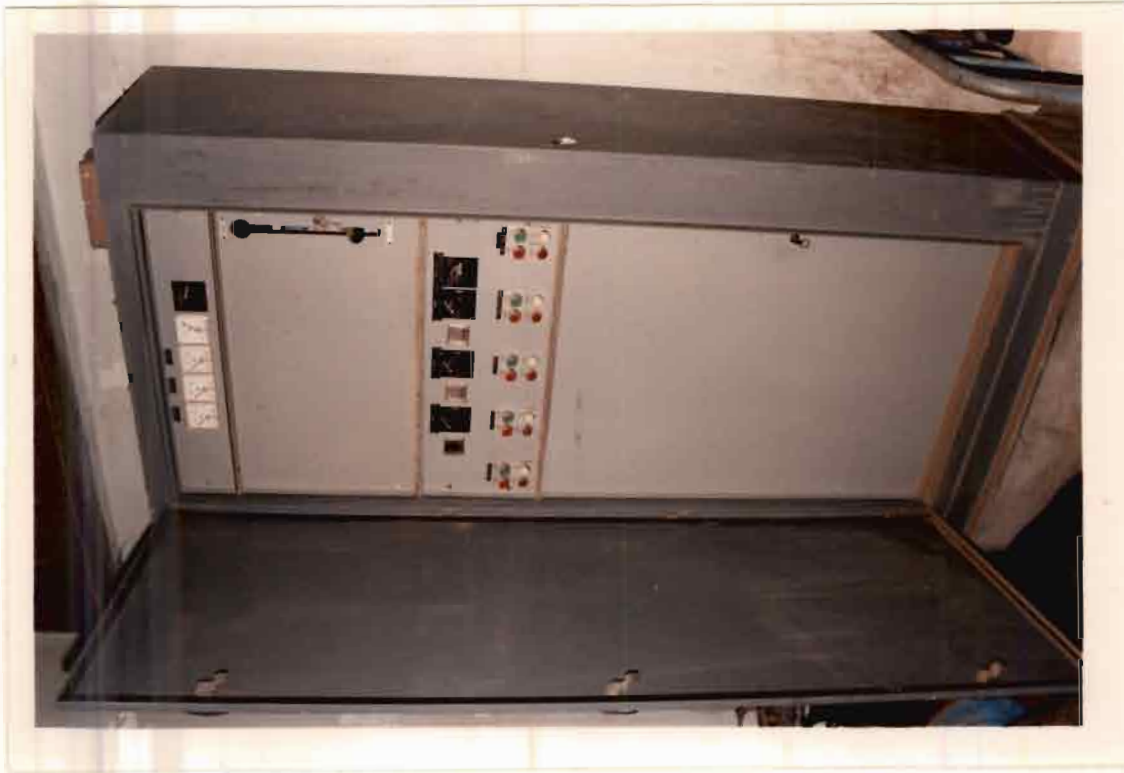
↑ Photo n°5 : ARMOIRE ÉLECTRIQUE DE COMMANDE
