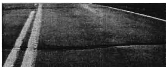
Figure 2.7: Photo d'une fissure transversale sur une route revêtue.
