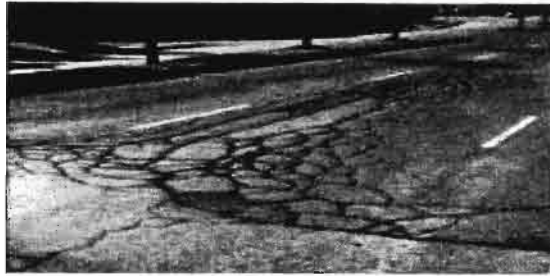
Figure 2.10 : Photo de fissures en carrelage sur une route revêtue.
