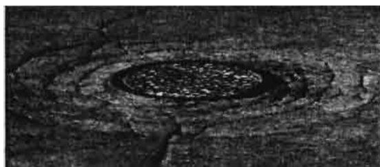
Figure 2.19 : Photo montrant une fissuration autour d'un regard.
