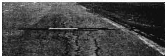
Figure 2.14 : Photo montrant l'affaissement d'une route revêtue.
