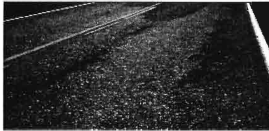
Figure 2.16 : Photo montrant le désenrobage d'une route revêtue.
