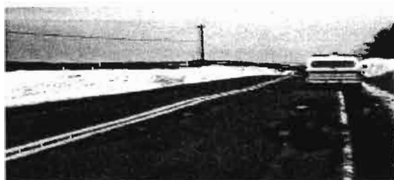
Figure 2.15 : Photo montrant le soulèvement différentiel d'une route revêtue.
