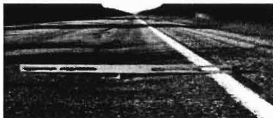
Figure 2.13 : Photo d'ornières à grand rayon sur une route revêtue.
