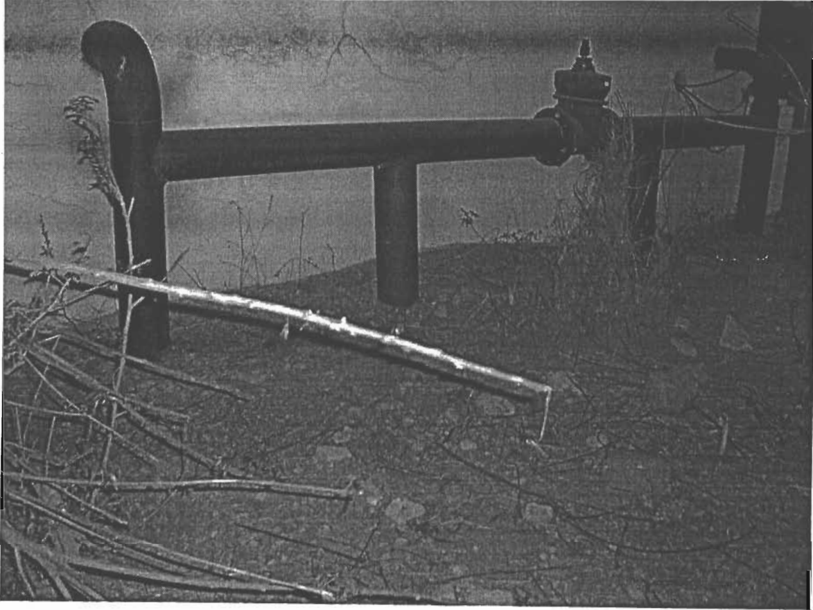
Photo 3.3 : Système de by-pass
