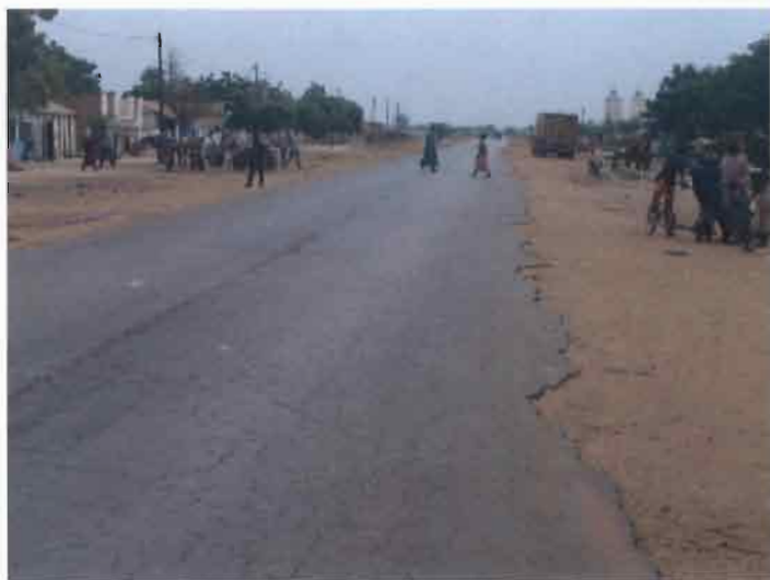
Photo 6 Epaufures et déficit d'accotement
