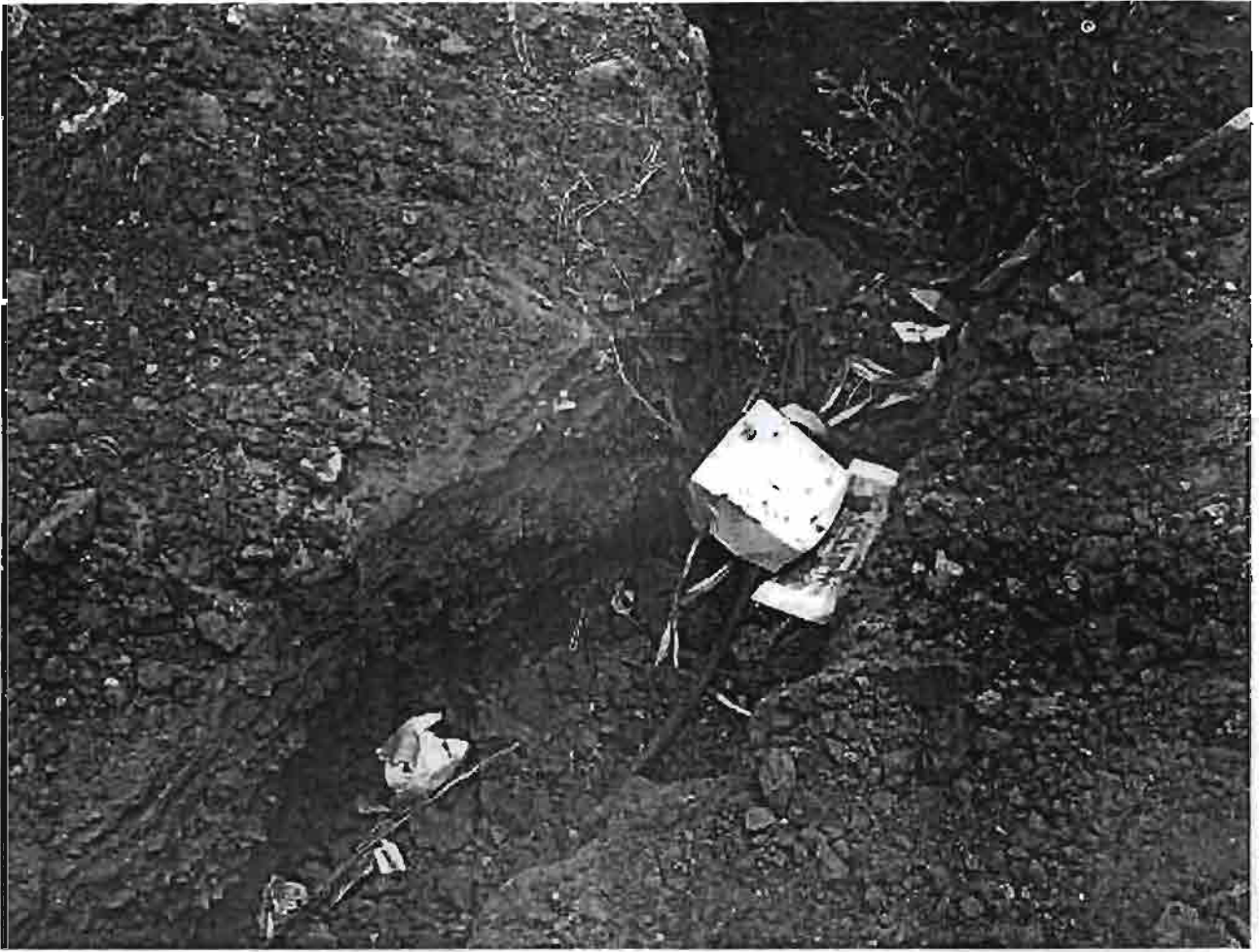
câble RO2V enterré
