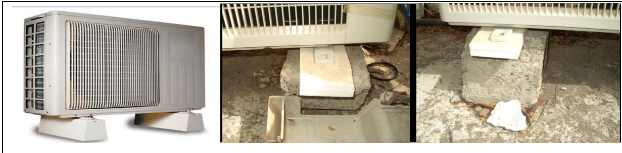
Figure 44: Calles standards à gauche contre les calles artisanales en briques de ciment à droite.
