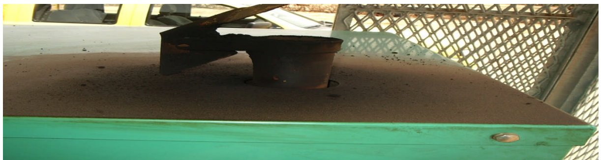
Figure 22: Dispositif d'échappement d'un GE.
