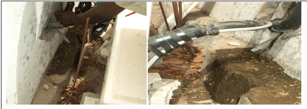
Figure 40: Risques d'infiltration de la dalle (terrasse) par les eaux de condensation.
