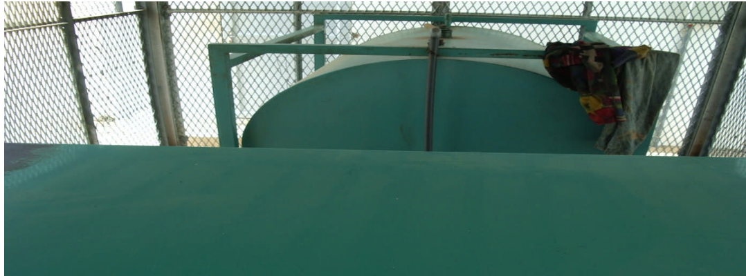
Figure 19:Etroite cohabitation du GE et de la citerne de réserve dans le local.
