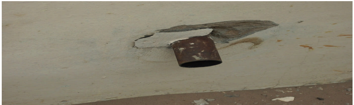
Figure 21: Raccordement insuffisant de la tuyauterie d'échappement.
