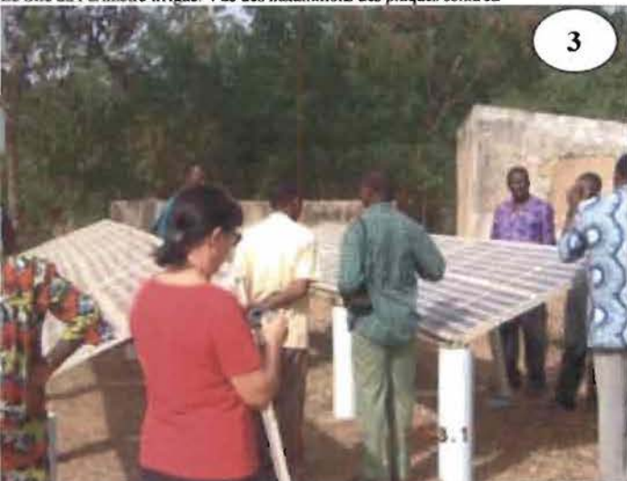
Le Site du Périmètre irrigué. Vue rapprochée des installations des plaques solaires.
