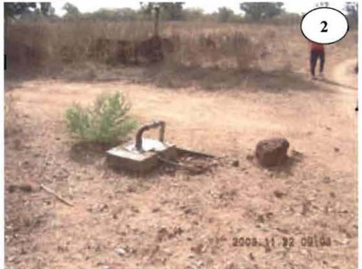
Le Site du Périmètre irrigué. Vue du forage dont la pompe est en panne depuis 2000.
