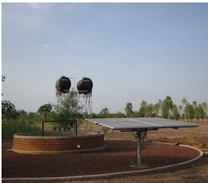
Photo 5: Système de pompage d'eau des puits (cliché de MEDA, 2011)
