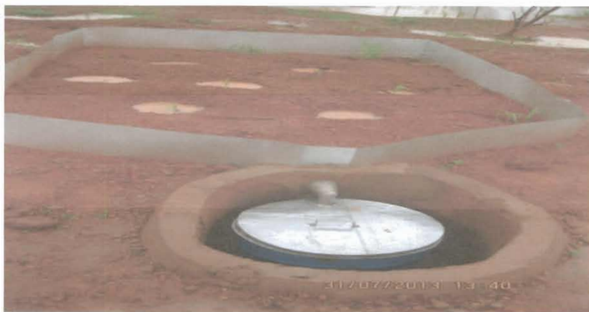
Photo (3): dispositif de la collecte des eaux de ruissellement
