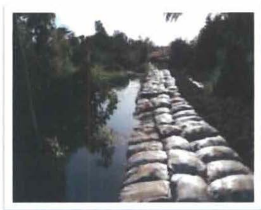
Photo 7: Efforts de protection des berges en aval du pont de Dindéresso en 2012
