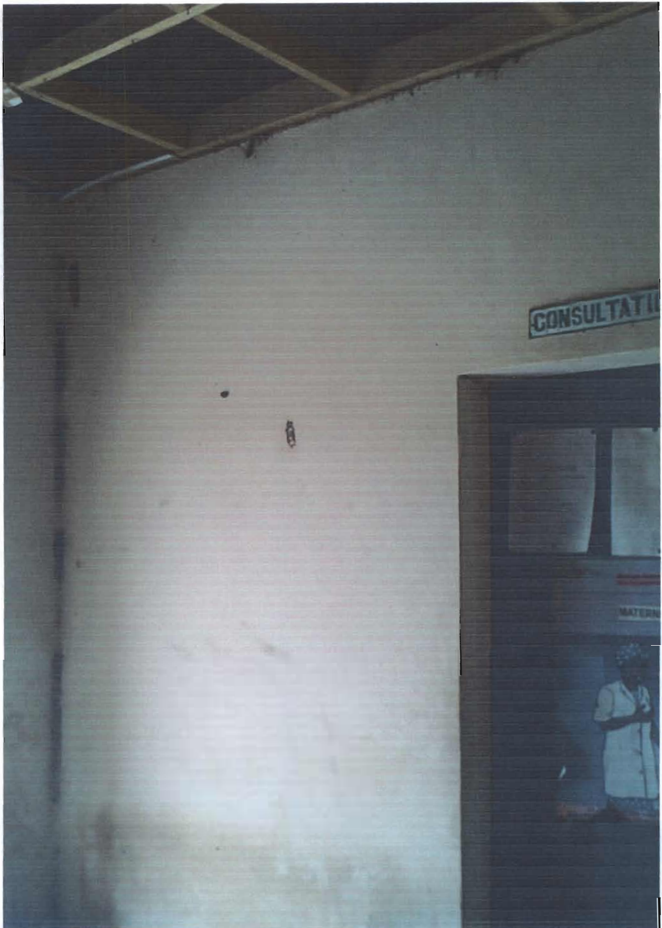
Iconographie 4 : Mauvais état des infrastructures.
