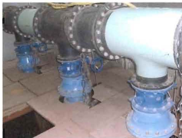
Photo1 : Captage et adduction de l'eau brute de la source ONEA I vers la station de traitement (station de traitement d'eau de Nasso)
