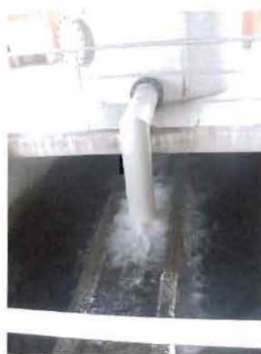
Photo 3 : Filtration et minéralisation de l'eau aérée à travers le lit de carbonate de calcium (station de traitement d'eau de Nasso).
