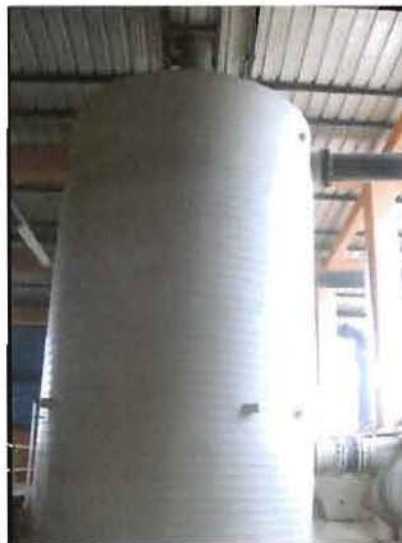
Photo 2 : Aération de l'eau à contre-courant dans un ruisseleur (station de traitement d'eau de Nasso).
