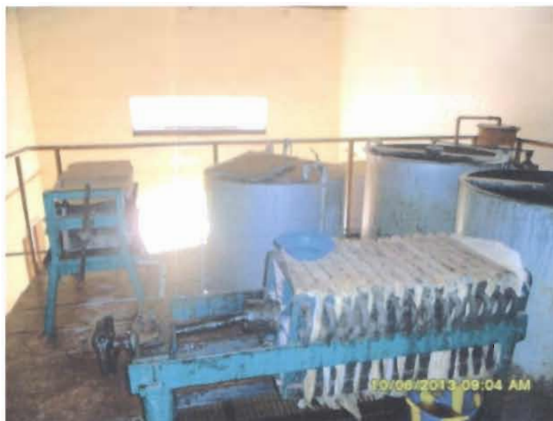
Photo 5 : les filtres presses
