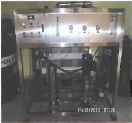
Photo1 : Machine de filtre à eau
