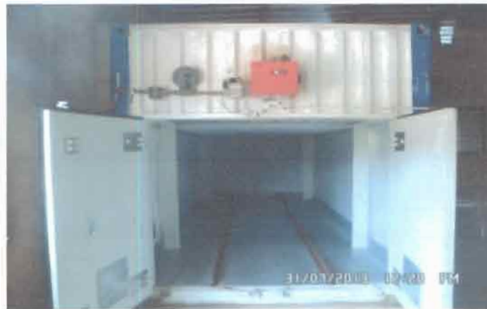
Photo 4. Image d'un séchoir Tunnel CD 1500
