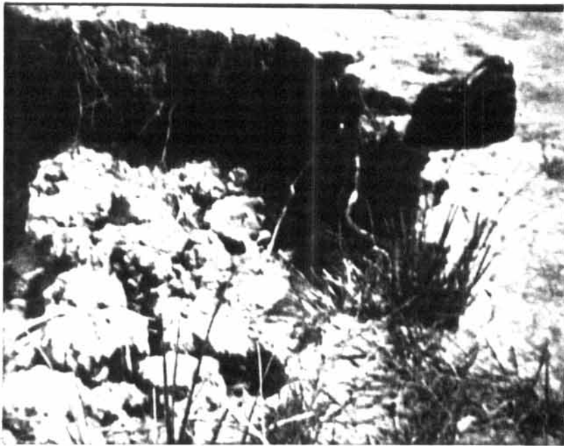
PHOTO N° 4 : Effondrement de tête de ravine.
