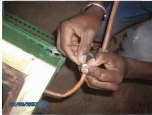
12. Interconnexion des canalisations
