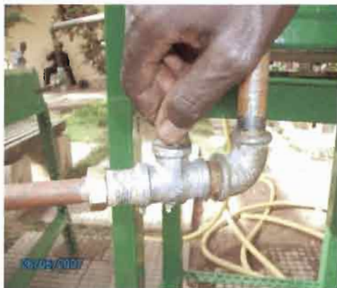
13. Point de purge
