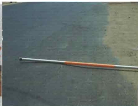
Figure III.7 : Bourrelet mis en relief par la surélévation du jalon (RN2)
