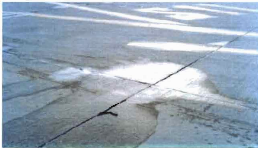
Figure III.35 : Pompement caractérisé par l'humidification de la chaussée aux bords des joints
