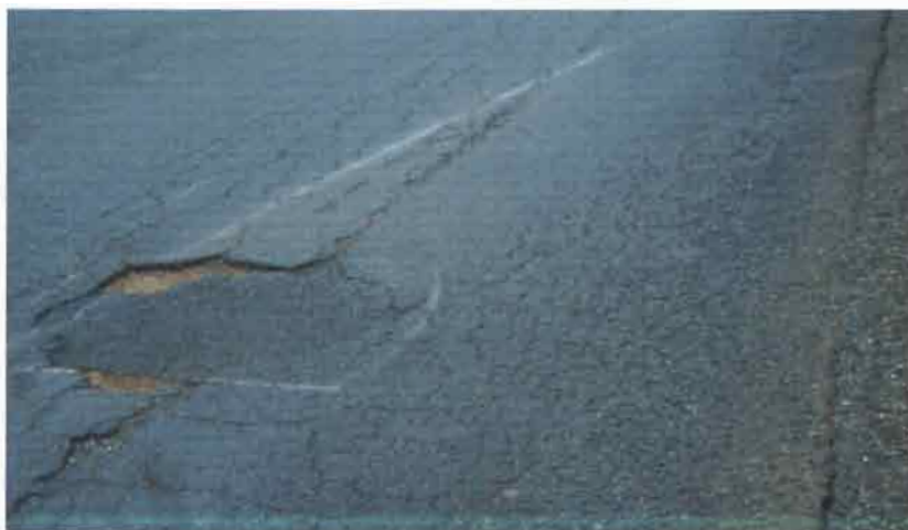
Figure III.10 : Réseau de fissures longitudinales (RN3)
