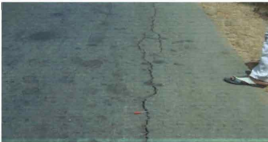
Figure III.9 : Fissure longitudinale avec ouverture franche (Notto-Bayakh)
