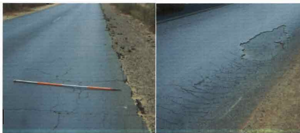
Figure III.11 : Début de faïencage (RN2) Figure III.12 : Faïencage de maille serrée (RN3)
