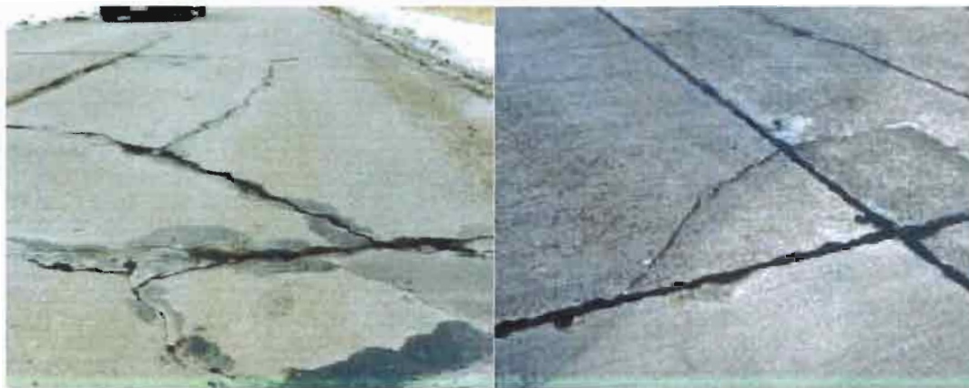
Figure III.31: Réseau de fissures de formes diverses Figure III.32: Fissures en coin de dalle
