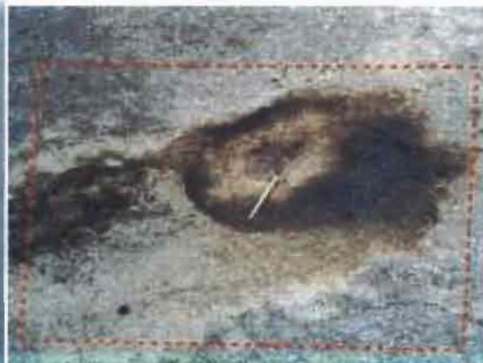
Figure III.30: Remontée de boues
