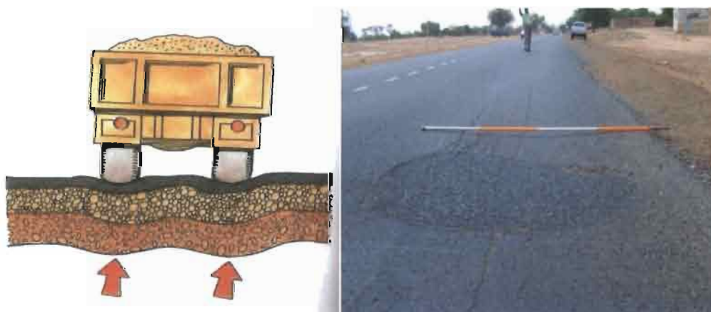
Figure III.4: Schématisation d'une ornière Figure III.5 Ornière sur la RN3 (Thiès-Diourbel)
