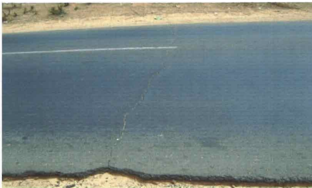
Figure III.8 : Fissure transversale affectant toute la largeur de chaussée (RN2)
