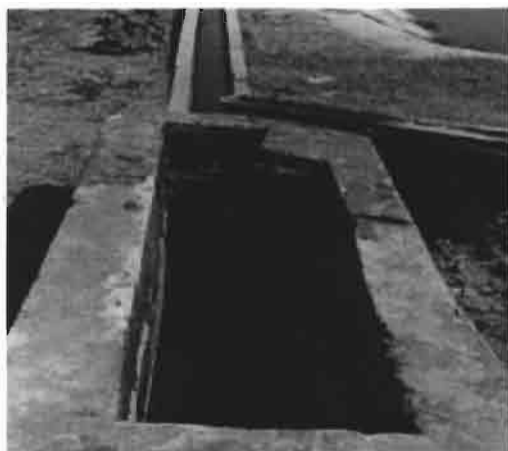
Regard et canal de trop plein
