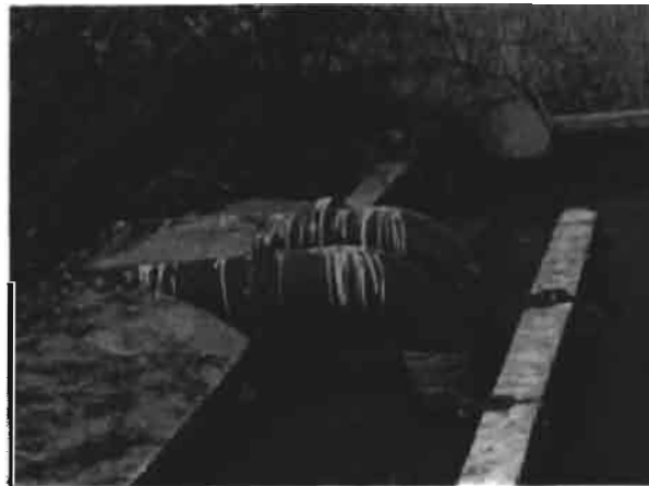
Conduites de refoulement : arrivées d'eaux brutes à la step
