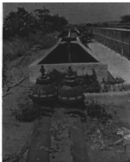
Jaugeur de Parshall et conduites alimentant le décanteur
