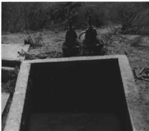
Eaux issues du prétraitement et vannes
