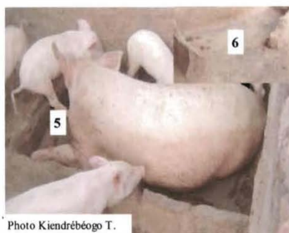
Photo 7: Abreuvoir détérioré (5 et 6) en maçonnerie fixe dans le type B utilisé comme baignoire par les porcs
