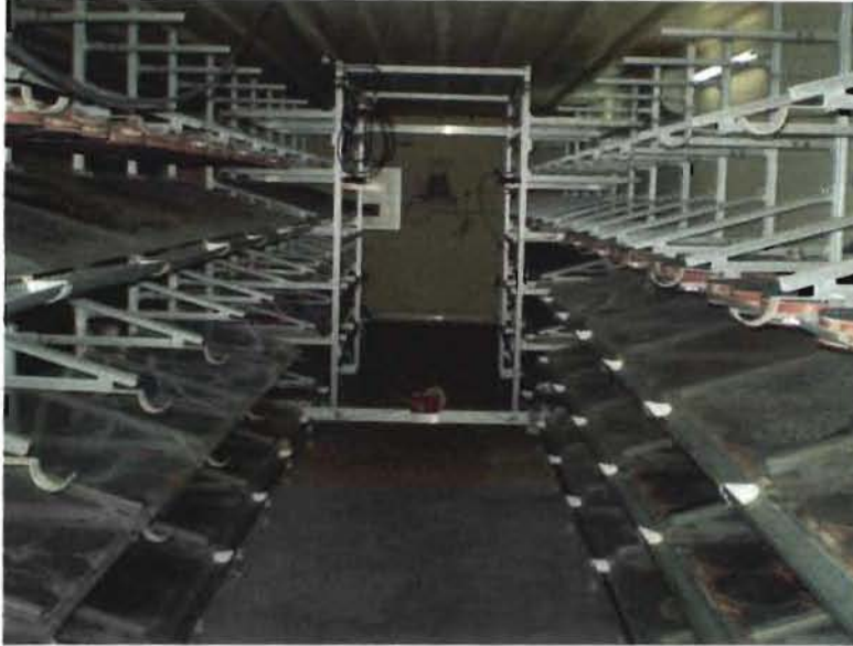
Figure 10: Vue d'ensemble du TPU-3
