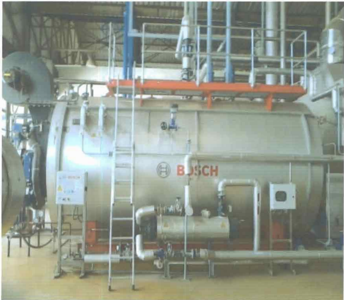
Photo3 : Chaudière vue de profil
